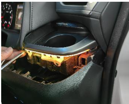
5.撬开主驾下方饰板，将我司埃尔法主控幻彩线标“主驾”标签的灯头走入此位置，并替换上我司灯具
